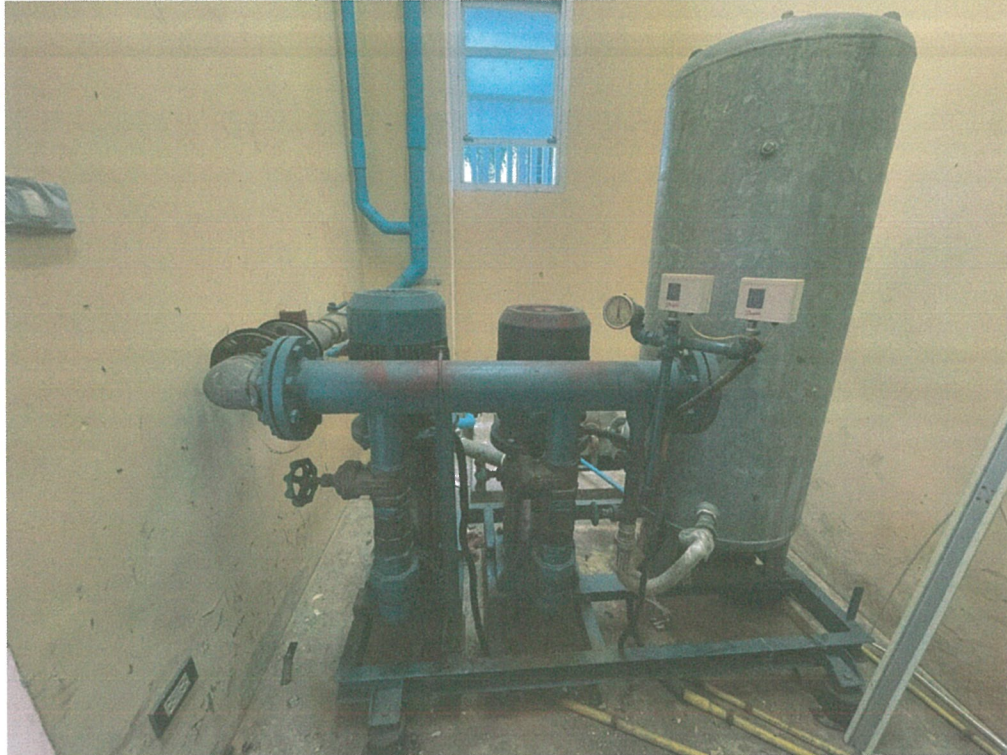
ภาพที่ 5 เครื่องสูบน้ำเพิ่มแรงดันของเดิม
