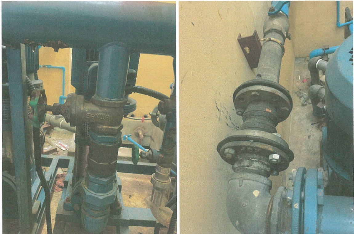
ภาพที่ 6 เครื่องสูบน้ำเพิ่มแรงดันของเดิม
