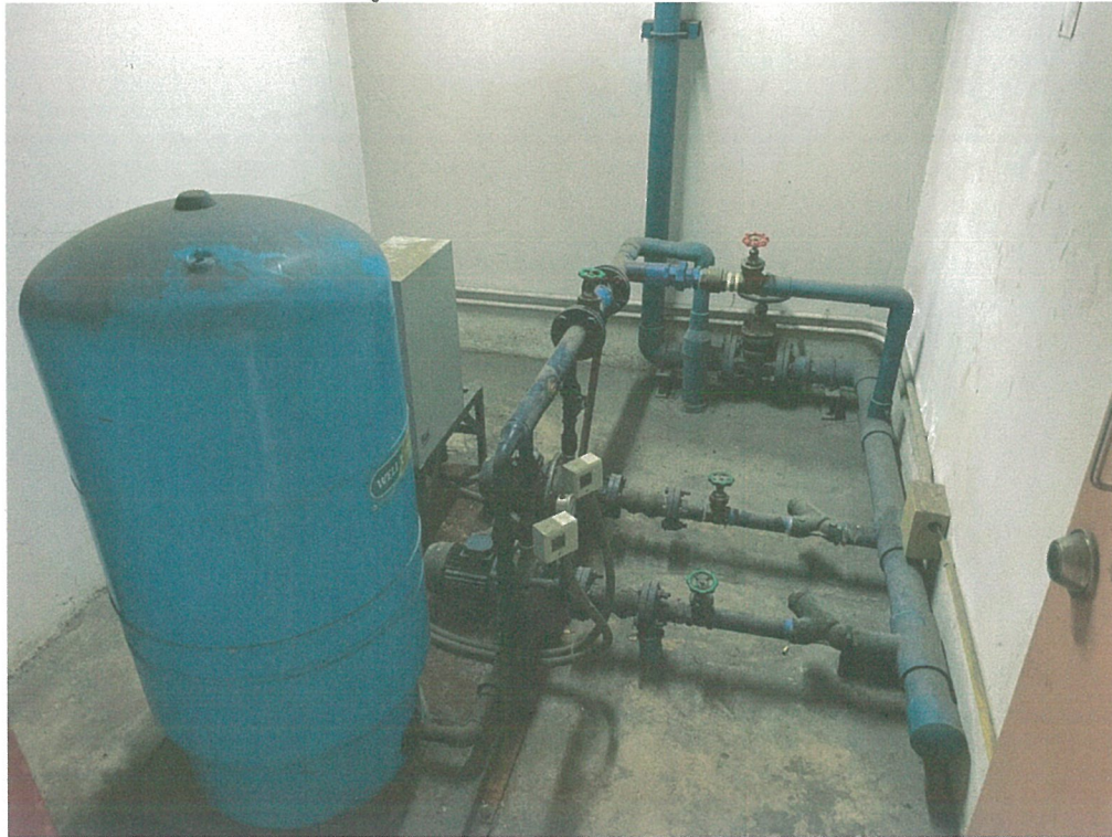
ภาพที่ 3 เครื่องสูบน้ำเพิ่มแรงดันของเดิม
